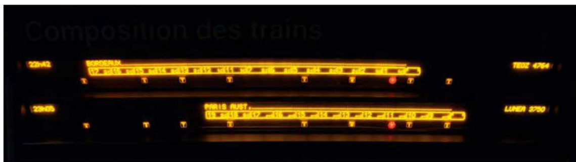
Figure 4.4 – Affichage en gare utilisant des modules LED.
