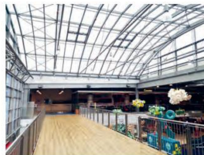
Système de désenfumage quasiment invisible dans le toit de la galerie
