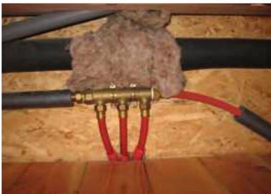
Distribution des tuyaux d'eau chaude. (© Bruno Onfray.)
