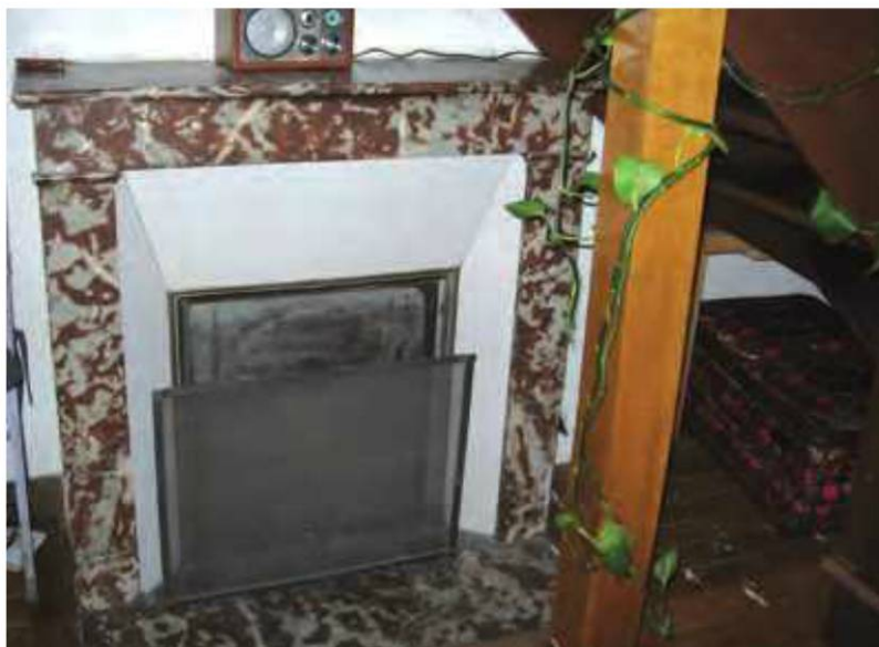
Exemple de cheminée d'appartement typique. Ne négligez pas la trappe, qui permet de fermer le foyer, évitant ainsi la déperdition de chaleur lorsqu'il n'y a pas de feu.
