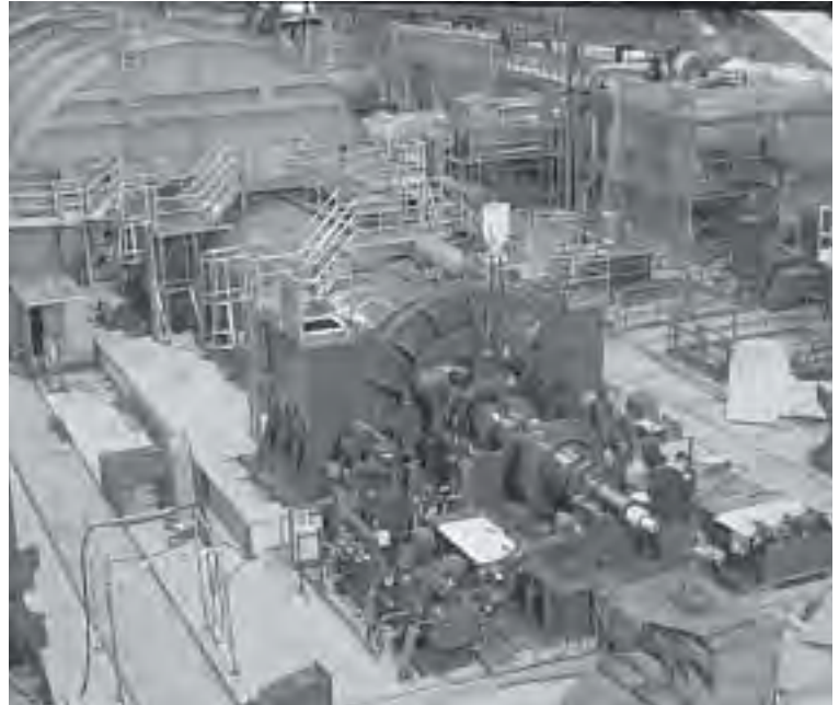
Photo 7.8 EDF. Salle des machines de la centrale nucléaire de Saint-Laurent des Eaux.
