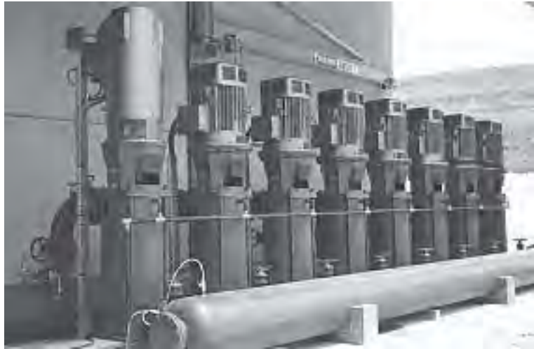
Figure 17.7 Unité de pompage liquide pour le réseau d'irrigation.
