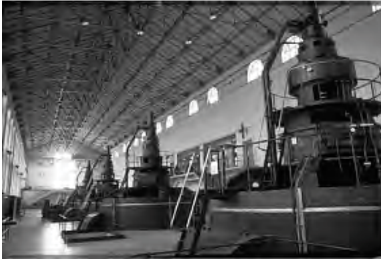
Photo 7.5 EDF. Centrale hydraulique de Pragnères
