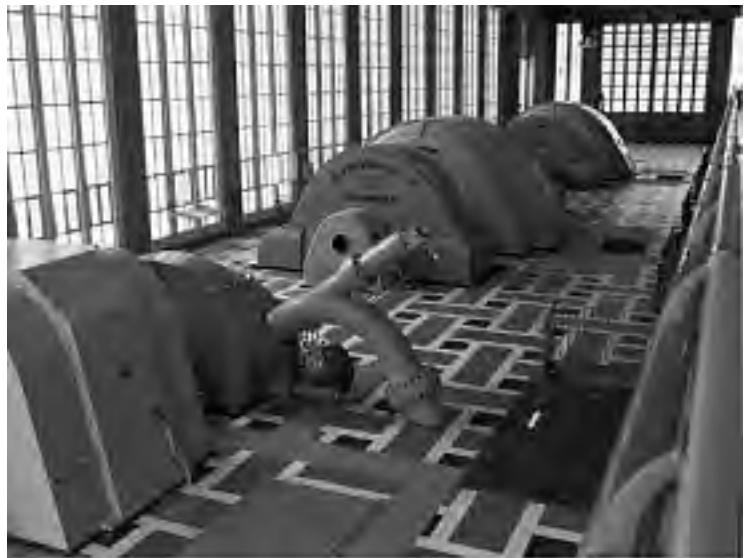
Photo 7.4 EDF. Aménagement hydraulique de la Durance, Centrale de Sainte-Tulle
